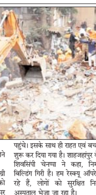
शाहजहापुर में एक निर्माणधीन इमारत ढही, कई मजदूर दबे हटसे के वक्त बिल्डिंग में 45 मजदूर कर रहे थे काम
